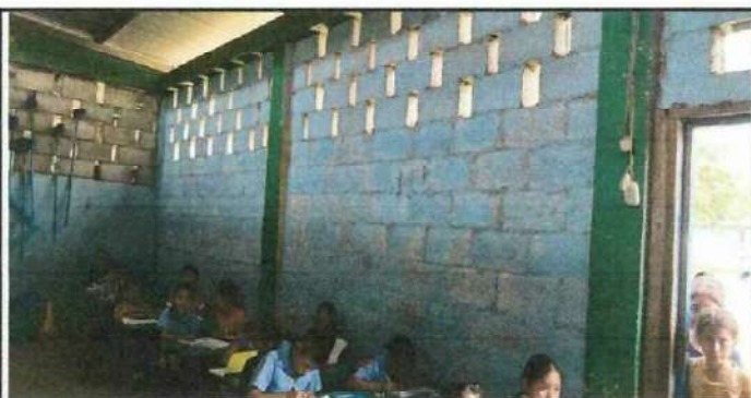
Foto 3: En esta fotografia se puede observar que el block de la pared necesita ser repellada y pintada
