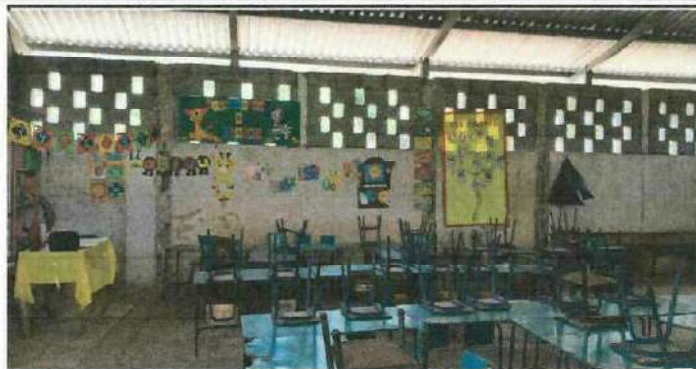
Foto 2: En esta fotografia se puede observar que parte de la pared necesita ser repellada y pintaria.
