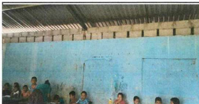
Foto 4: En esta fotografia se puede observar que la pared necesita ser repellada y pintada.
