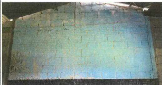
Foto 1: En esta fotografía de modulo 1 se observa que la pared esta en mal estado y que necesita ser repellado y pintarlo,
